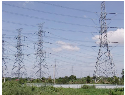
เสาไฟฟ้า
